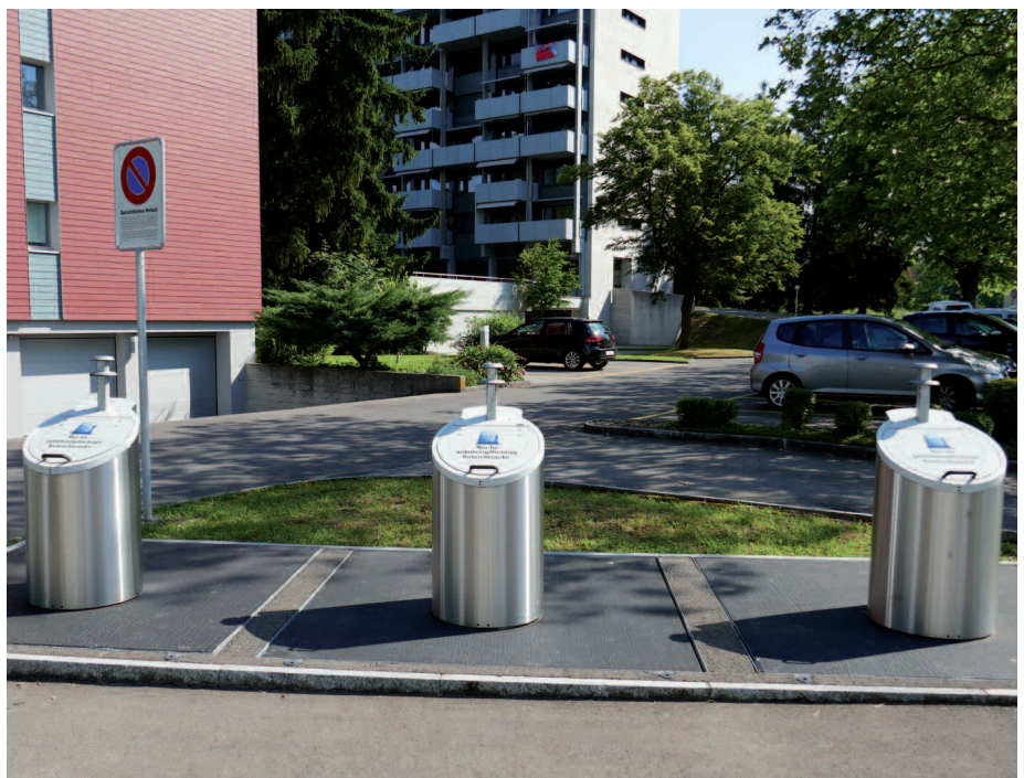
Die Sammelanlage mit drei UFC kann bis 24 Rollcontainer und den wöchentlich anfallenden Hauskehricht von rund 270 Haushalten aufnehmen.
